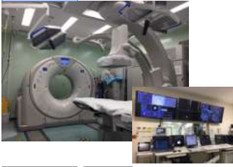
IVR-CT装置 CT装置 110KVA、127KVA IVR装置 170KVA
